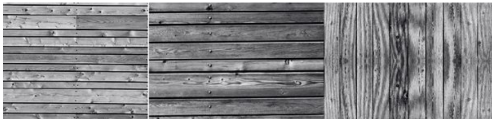
Příklad stárnutí dřevěné fasády
